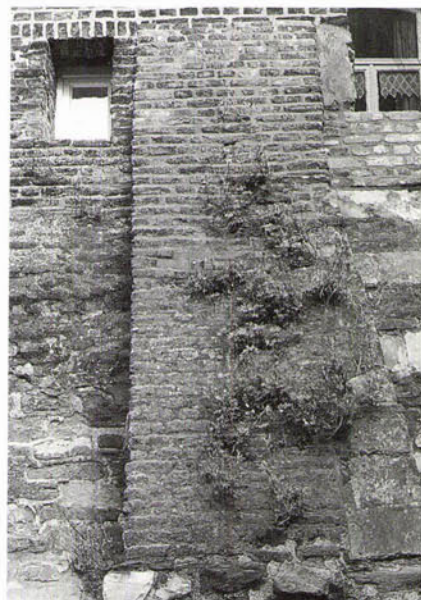
FIGUUR 9b. Steunbeer ná de consolidatie. Omdat het metselwerk aan de bovenzijde van de steunbeer erg los zat, zijn hier de meeste planten verwijderd (foto: B. Kruyntjens).
