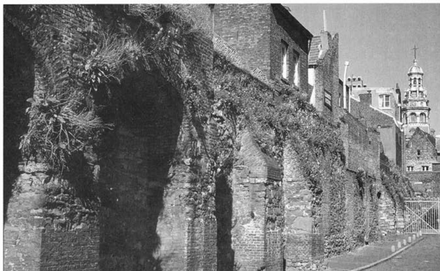
FIGUUR 2. De walruur aan de Preekherengang in 1995, vóór de consolidatiewerkzaamheden. Links bevinden zich de muurbogen en in het midden en rechts de steunberen. Vooral de hogere delen van de muur en de steunberen zijn rijkelijk begroeid (foto: B. Graatsma).
