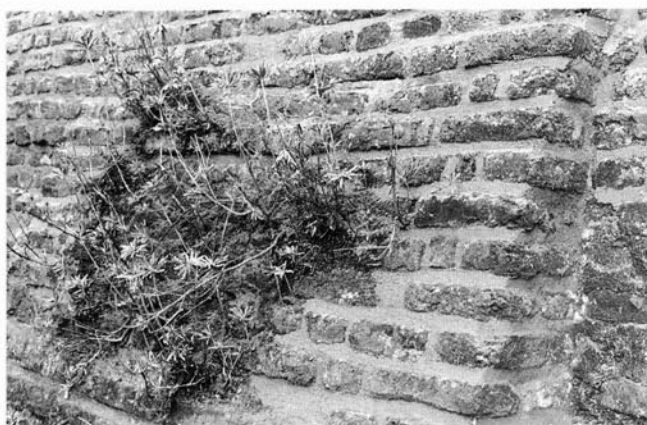
FIGUUR 5. Op de schuine delen van de steunberen heeft zich in de loop der jaren humus verzameld. Tijdens de werkzaamheden is de humus niet verwijderd (foto: B. Kruyntjens).
