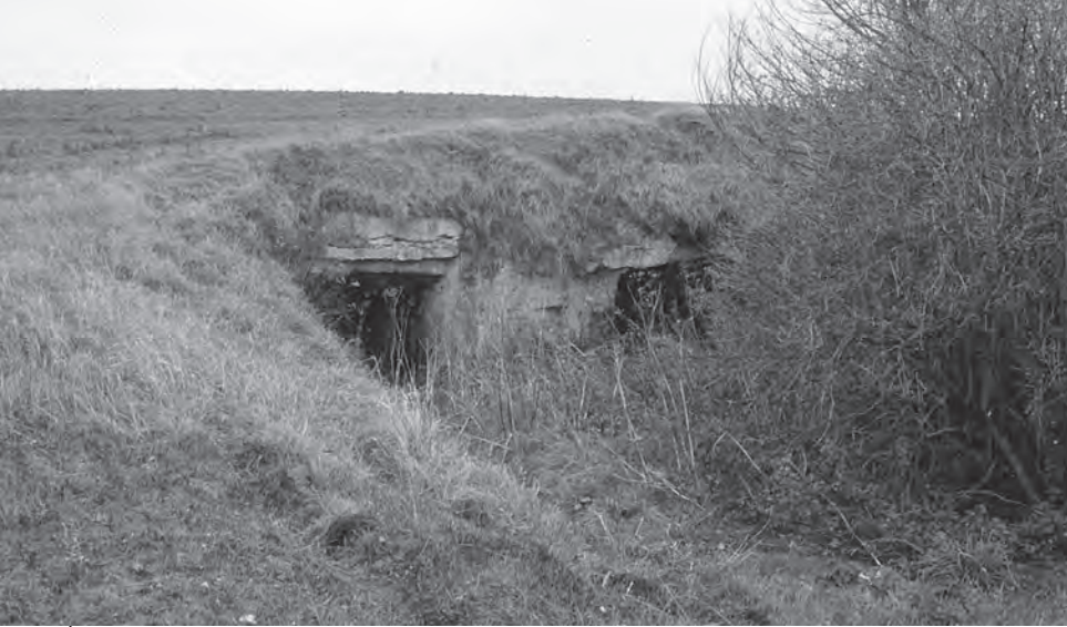
AFBEELDING 2: Het 'dak' van de onderaardse groeven is vaak opvallend dun maar stevig genoeg door het harde karakter van een kalksteenlaag die bekend staat als hardground (foto J.Wanders).
