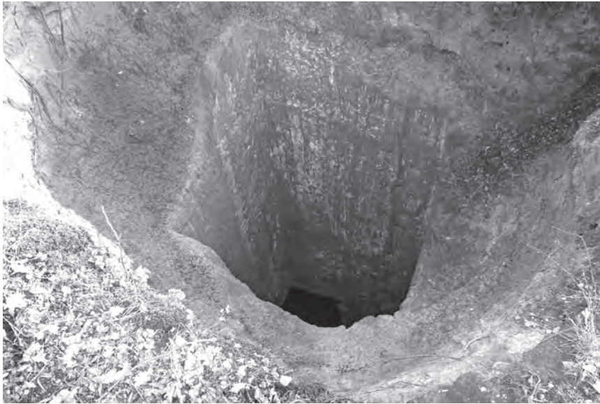
AFBEELDING 13: De in de mergel uitgekapte schacht is vierkant van vorm. In de deklagen had de schacht geen bekleding. Als gevolg hiervan is de nu zichtbare trechtervormige verzakking aan de oppervlakte ontstaan
