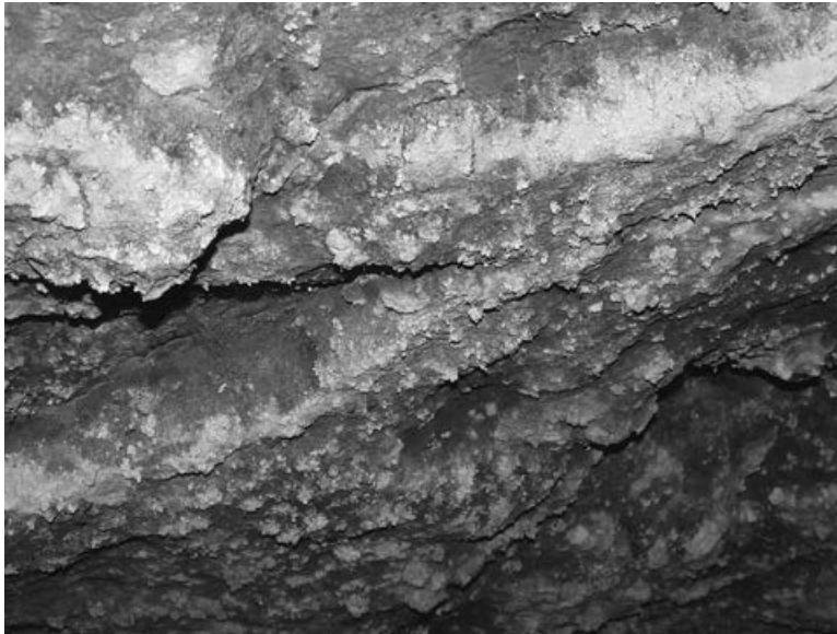
AFBEELDING 6: Salpeterafzetting tegen het plafond
