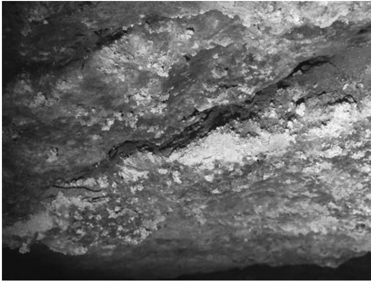
AFBEELDING 5: Salpeterafzetting tegen het plafond
